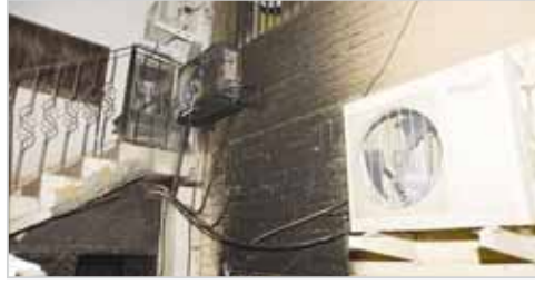
أثار الحريق كما بدت على واجهة المنزل
